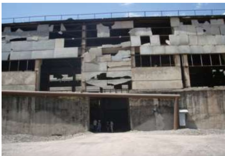
График0-1:Разрушение строения со значительным повреждением асбестовых плит
